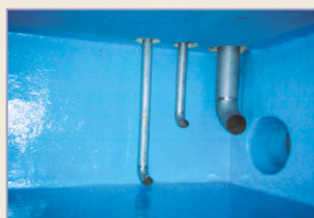
天井:設備配管
