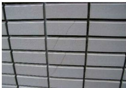
▲タイルの割れ
