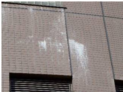
▲タイル割れ部からのエフロレッセンス（白華）の流出
